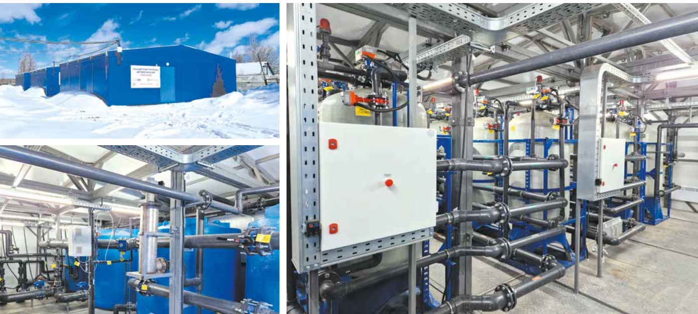
Рис. 6. Блочно-модульная станция водоочистки «Липовка». Технологическая линия мощностью 6 м 3 /ч
