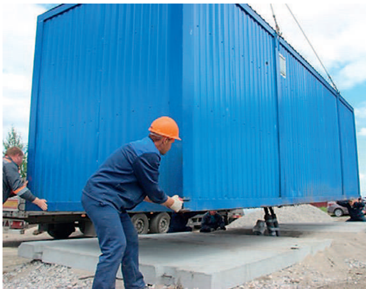
Установка блока станции на объекте. В качестве фундамента использованы стандартные дорожные плиты
